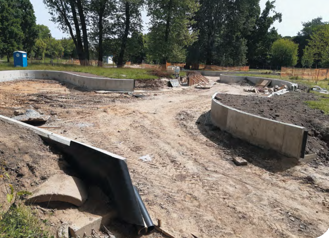
6 | Stawy w Parku Pole Mokotowskie w trakcie przebudowy, lato 2022 r. fot. Andrzej Kołodziejczyk
